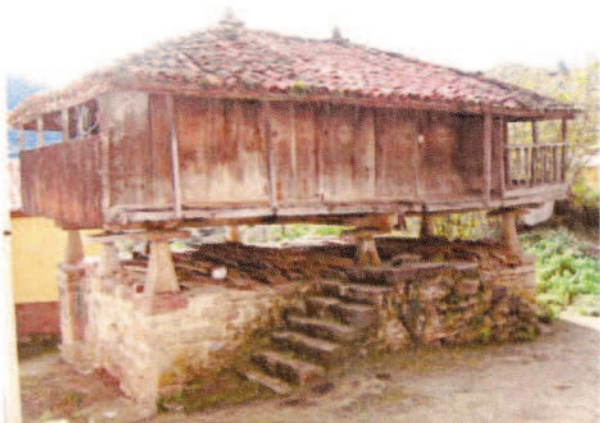
Lámina 1.- Vista general de la panera desde el frente principal situado al oeste.
